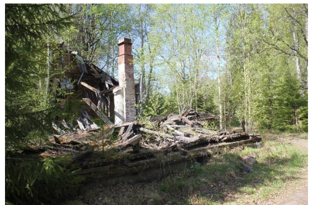
Kuva 7. Osa RKY-alueen rakennuksista on huonokuntoisia. Kuvassa oleva romahtanut rakennus on mahdollisesti asema-alueen vanha makasiinirakennus.
